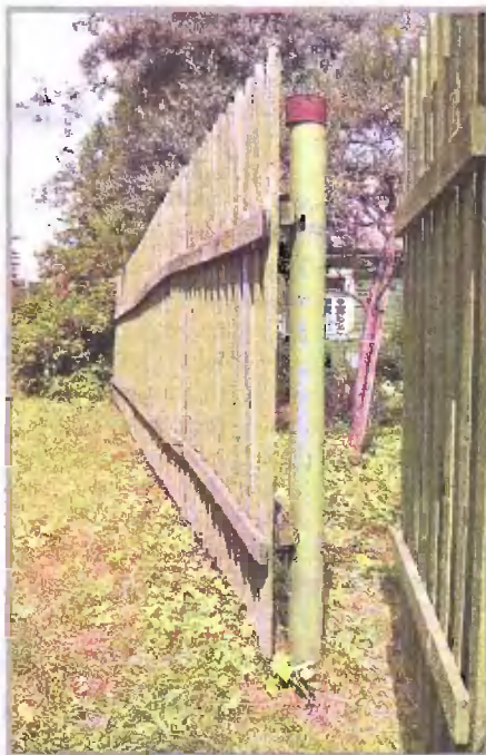
Старый забор требовал ремонта
